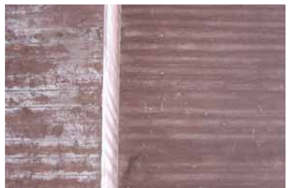
Abb. 41 Das bei nasser Witterung ausgeschalte Seitenteil (links) zeigt weisse Kalkausblühungen.
