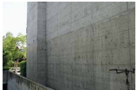
Abb. 39 Der Graffitischutz wirkt sich auf die Farbe der Betonoberfläche aus.
