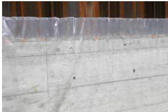
Abb. 13 Fachgerecht ge- schützte Anschluss- bewehrung.
