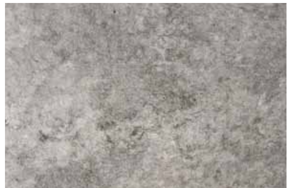
Abb. 40 Fleckige Dunkelverfärbungen nach einer Betonage unter winterlichen Bedingungen.
