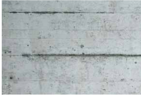
Abb. 20 Undichte Schalungsstösse zeichnen sich dunkel ab.
