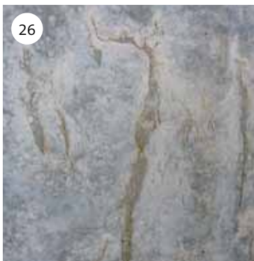
Abb. 26 Verfärbungen wegen Trennmittel- überdosierung.
