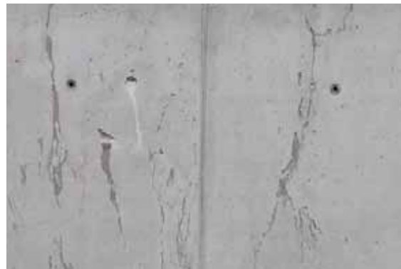
Abb. 43 „Wasserküchen“ infolge des Aufsteigens von Wasser an den Schalungswänden.
